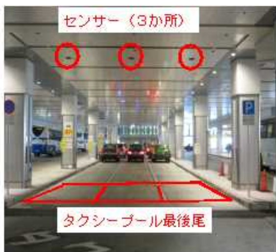
センサー設置状況
